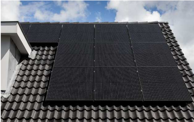
Voorbeeld van PV-panelen
